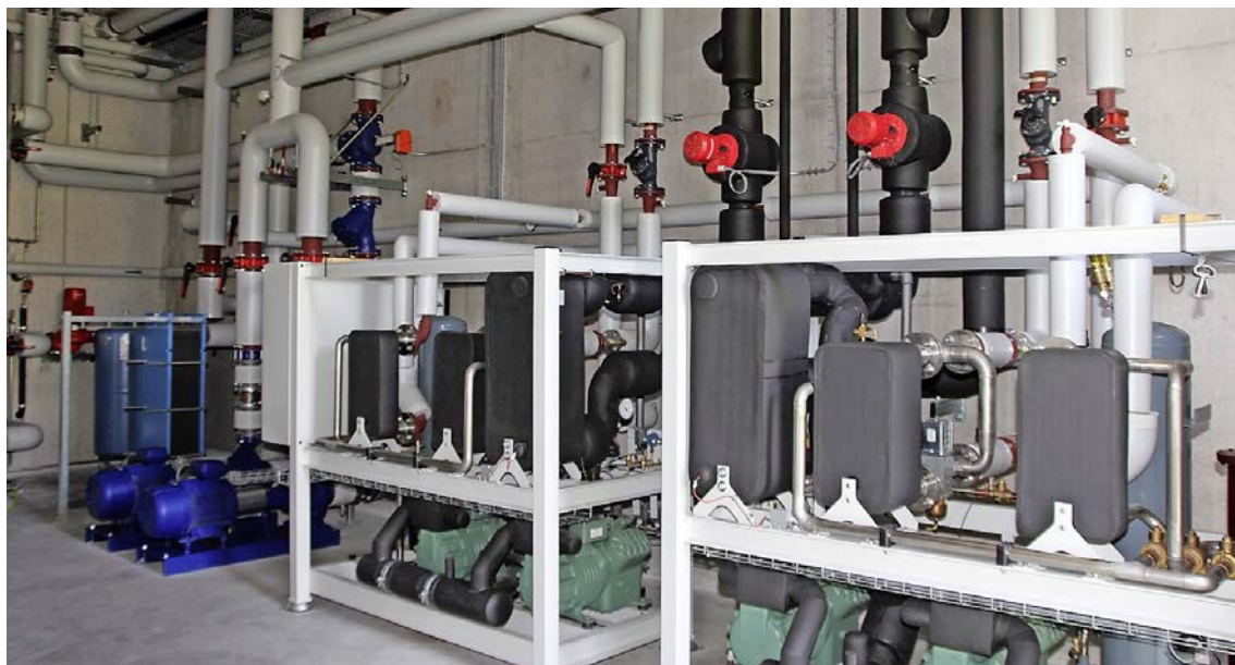
Dank ihrer neuen Kälteanlage kann die Gabriel Fleury SA massiv Strom sparen.
